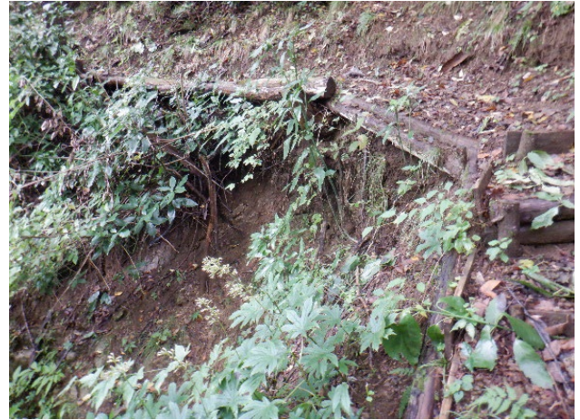
写真17 管理歩道直下の崩壊
