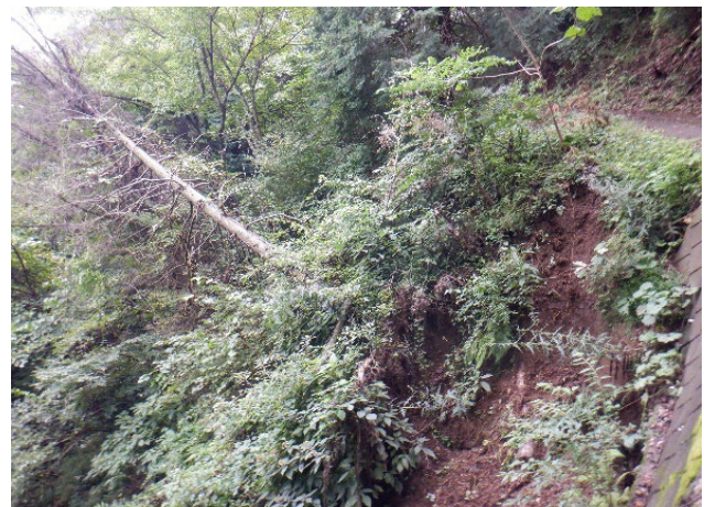
写真19 林道起点の崩壊
